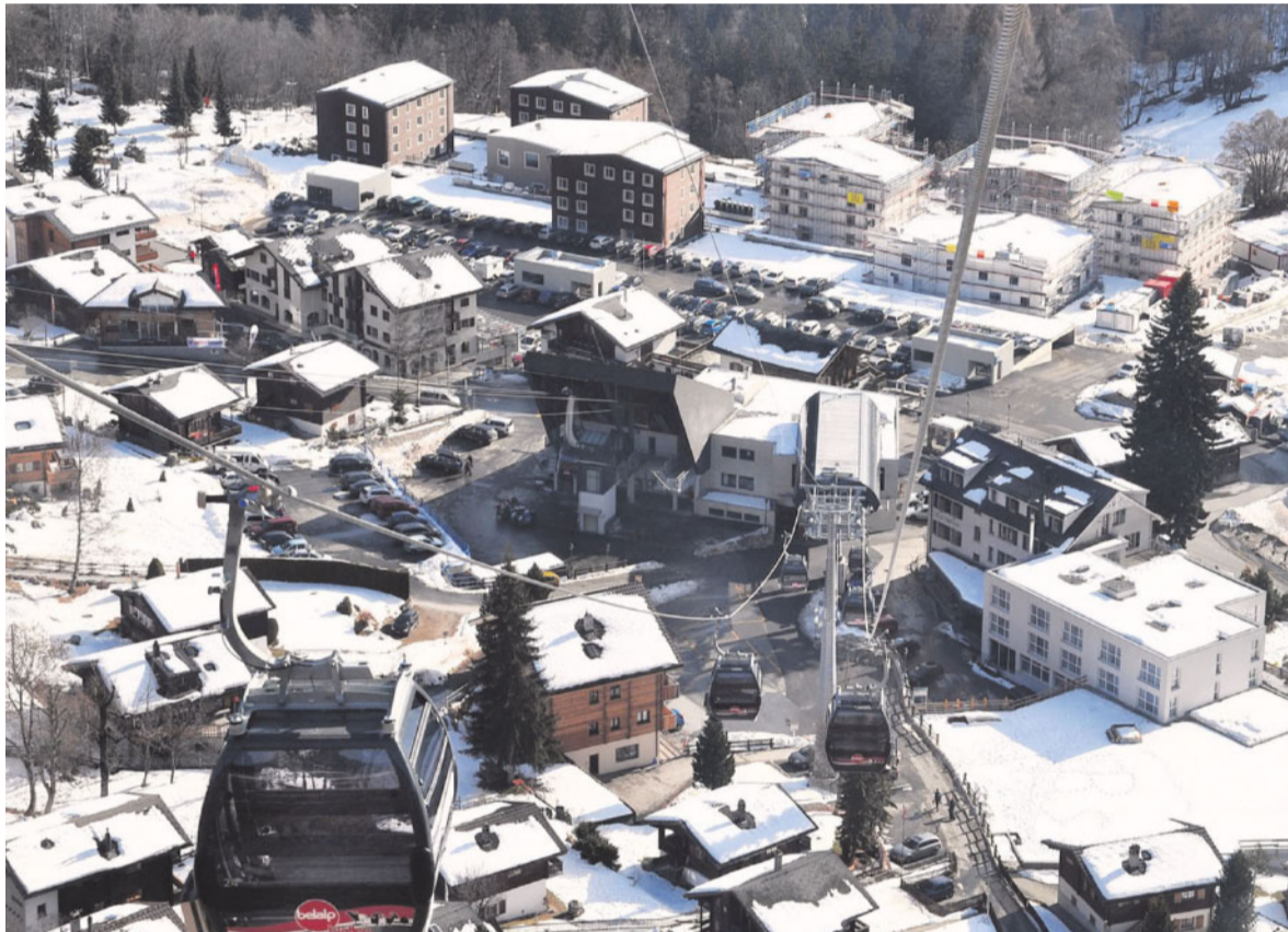
Millionenprojekte. Aussicht aus der 8er-Gondelbahn auf das im Entstehen begriffene Reka-Feriedorf. FOTO WB
